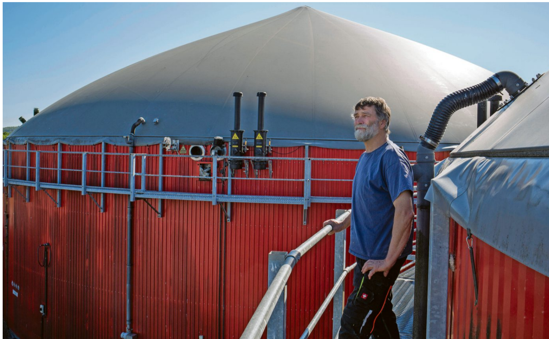
Auf Kontrollgang: Landwirt Harald Roloff ist zugleich Betriebsleiter der Biogasanlage in Altenstadt.
