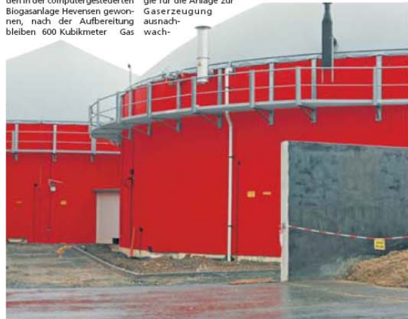
Auffällige Beschickungsanlage: Die Rohstoffe werden von hier automatisch zum Fermenter transportiert.
