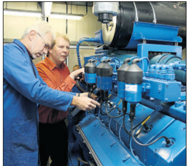
Modernes Blockheizkraftwerk in Betrieb: Karl-Heinz Göbel (links) von den Stadtwerken und Reinhard Kuhaupt, Projektleiter von E.on-Mitte, prüfen die neue Anlage neben dem Aqua-Park.
